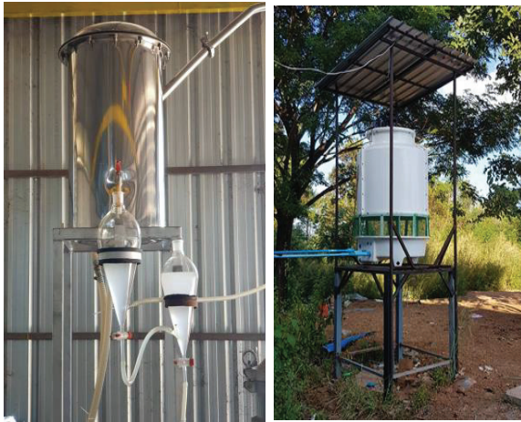
Figure 2 ชุดควบแน่นและคูลิ่งทาวเวอร์ระบายความร้อน
